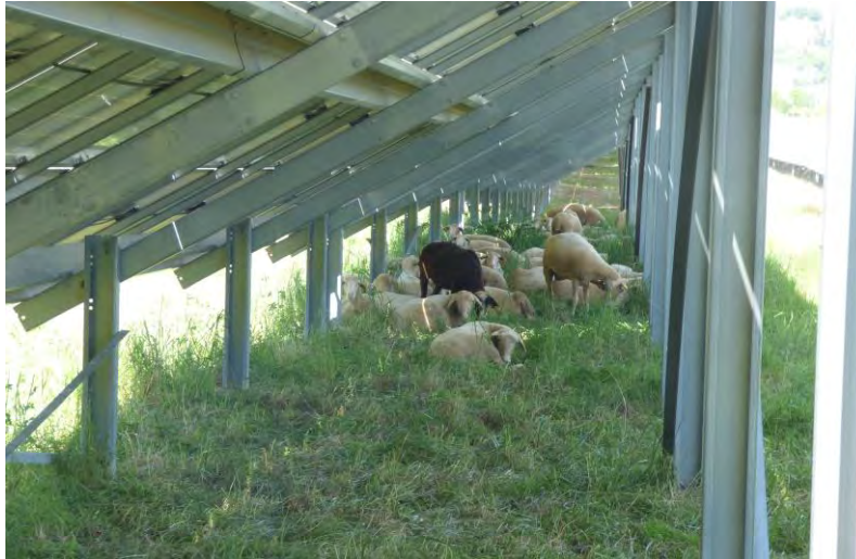
Figure 13 : Photographie de la centrale photovoltaïque « classique » de Séverac-le-Château (12), mai 2022 (Valeco)
